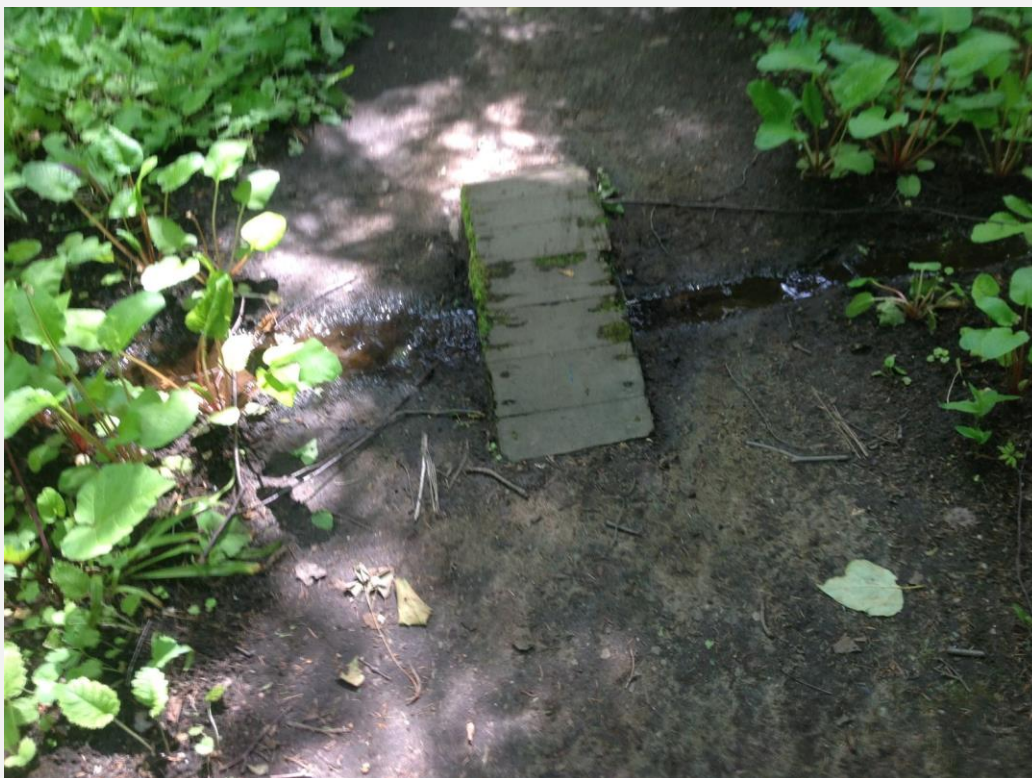
Ponceau dans les sentiers.... Pour brouettes des jardiniers
