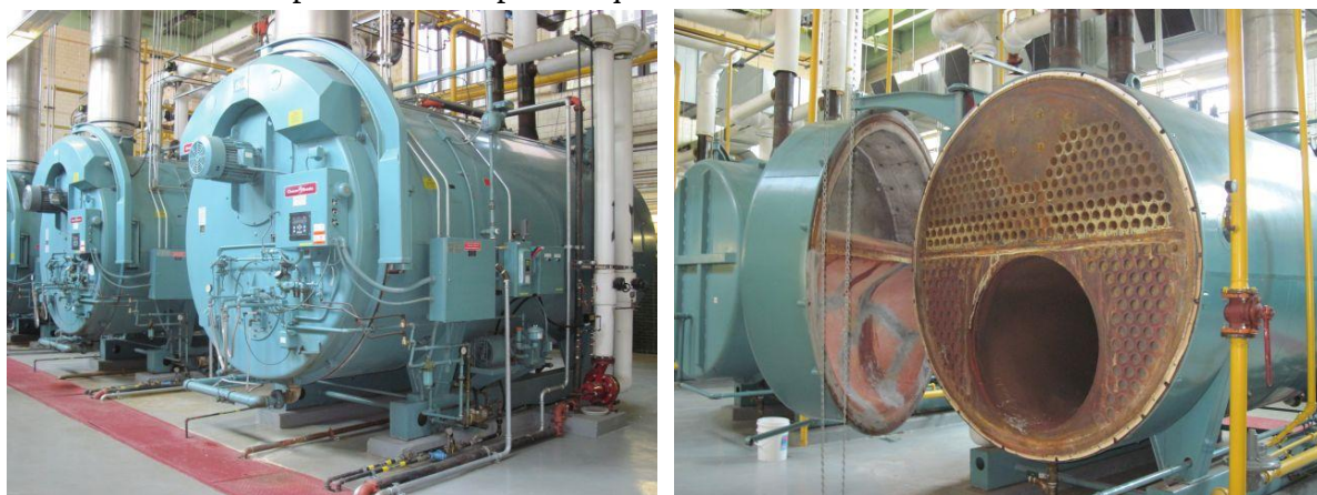
Quatre immenses cuves (boilers) pour le chauffage des serres et des bâtisses administratives
